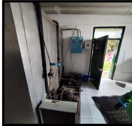
Fotografía 20. Maquinaria y compresores de refrigeración expuestos a nivel del suelo (riesgo SST).
