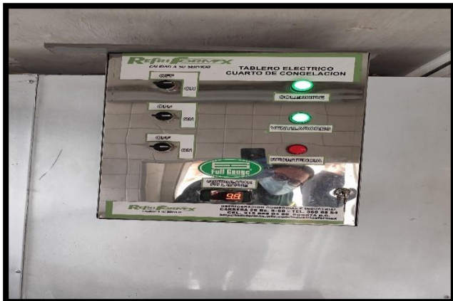
Fotografía 7. Tablero eléctrico exterior del cuarto de congelación.
