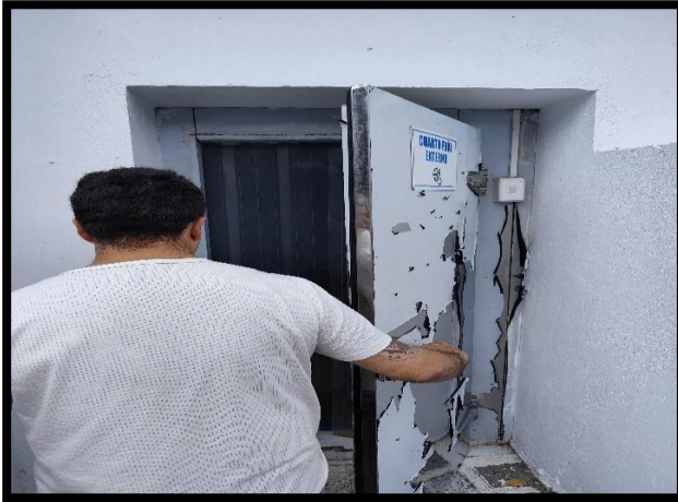
Fotografía 1. Puerta principal de acceso al Cuarto Frío 1.
