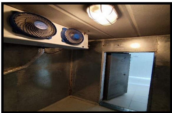
Fotografía 17. Sistema de ventilación interior del Cuarto Frío 2 sin uso.
