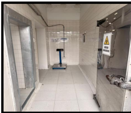
Fotografía 18. Báscula de pesaje ubicada en el pasillo exterior de los cuartos fríos.
